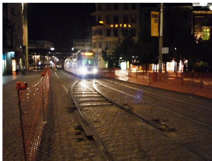
Vue de nuit de la liaison californienne installée aux abords de la station « Homme-de-Fer »
